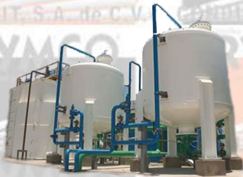
Tratamiento Agua Potable
